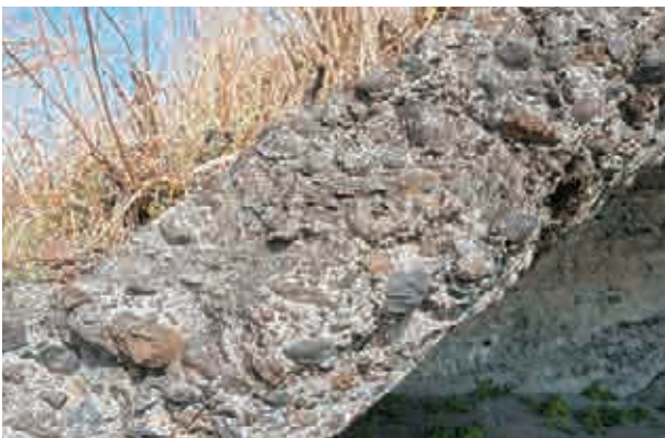
玉石の混じったコンクリート
