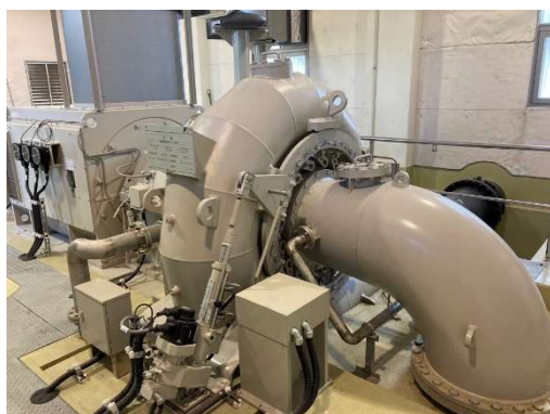
第1発電所発電機(フランシス水車)
