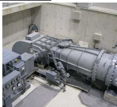
発電機(クロスフロー水車)
