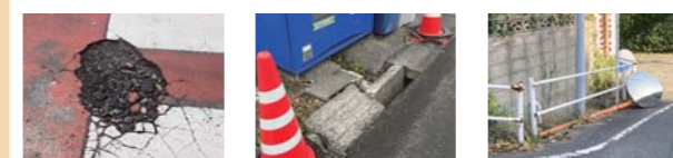
▲道路の異常箇所の例(穴ぼこ、蓋板割れ、ロードミラー倒れ)
