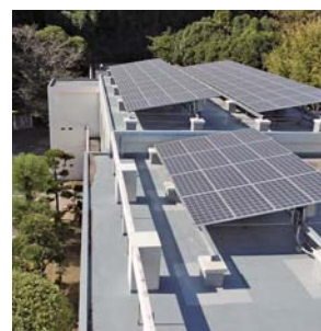
▲吾平総合支所の太陽光発電
