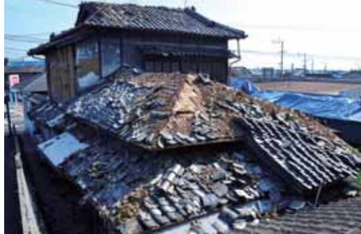
瓦が崩れ落ちた民家（宇城市中心部）
