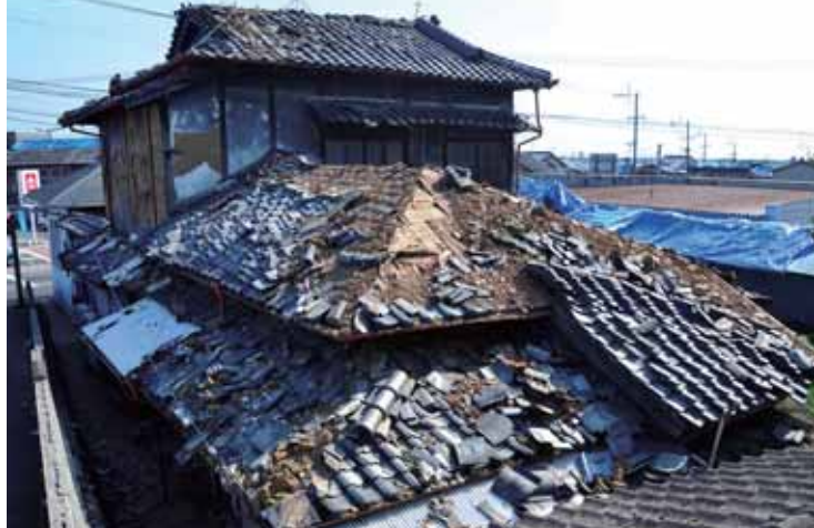
瓦が崩れ落ちた民家（宇城市中心部）
