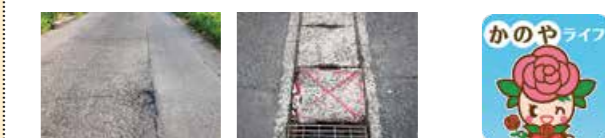
▲道路の異常箇所の例(穴ぼこ、蓋板割れ) ▲「かのやライフ」
