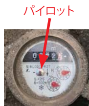
▲水道メーター
