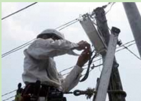
防犯灯を設置し、安全・安心の確保に努めています。
