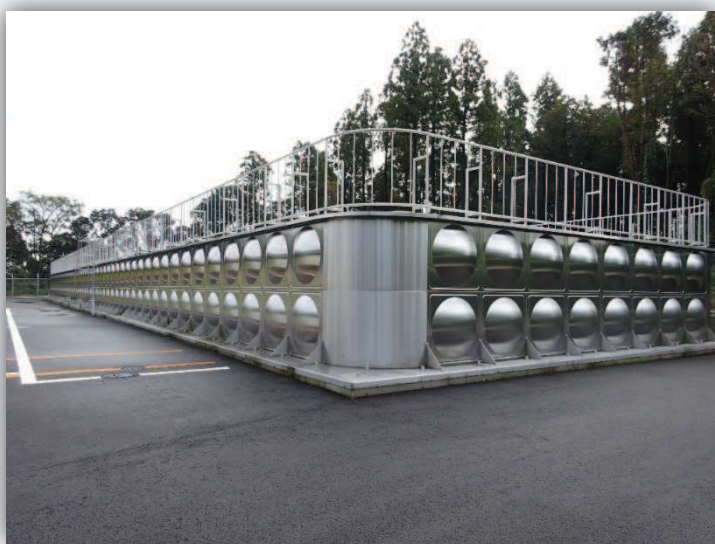
【横山配水池：SUS製半地下式】
