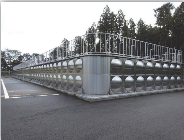
【横山配水池：SUS製半地下式】
