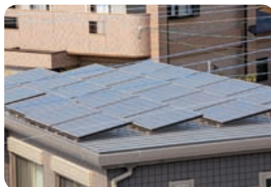
住宅用太陽光発電システム
