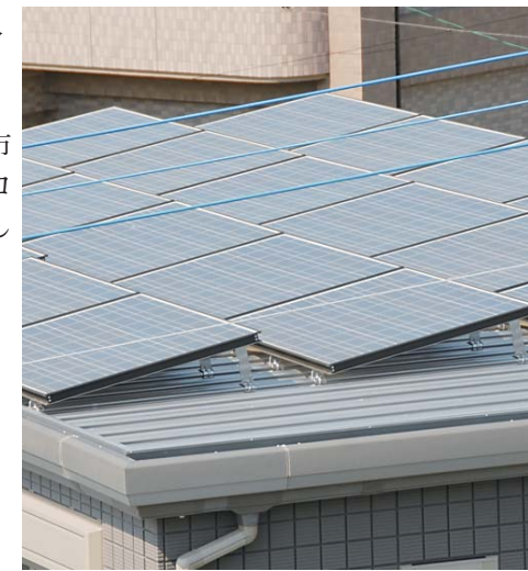
住宅用太陽光発電システム
