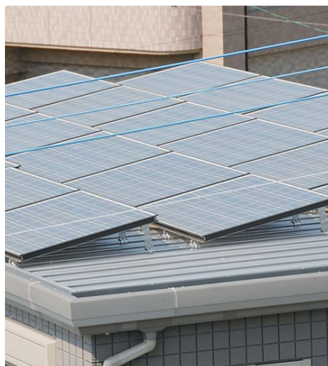
住宅用太陽光発電システム
