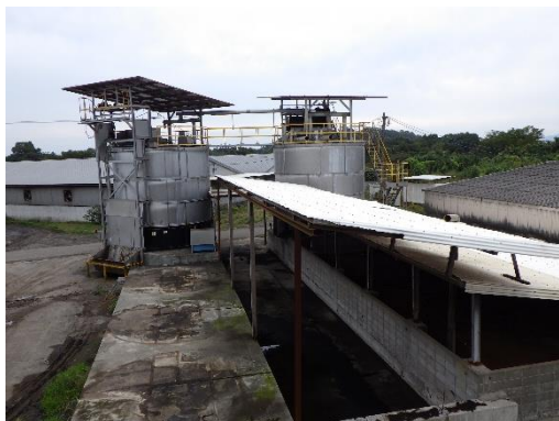
写真 6：縦型コンポと脱臭槽の設置例
