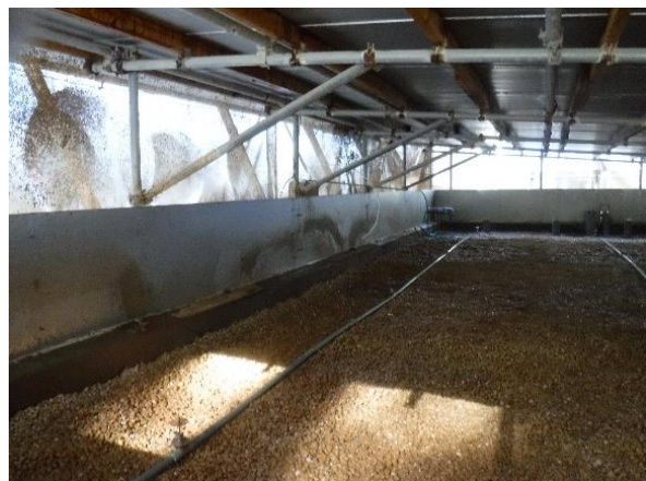
写真 10：脱臭槽を改造し「発泡ガラス」を充填対策事例 (スプリンクラーで定期的には水噴霧し、粉じん混ざりの回収水は水処理装置で処理します)
