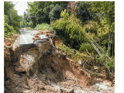
▲令和2年7月の豪雨災害で陥没した道路の様子
