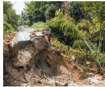
▲令和2年7月の豪雨災害で陥没した道路の様子
