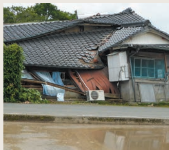
▲平成28年4月14日21時26分に発生した熊本地震の被害の様子 (気象庁ホームページより)
