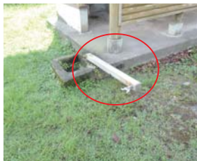
▲トイレの手洗場被害（水栓柱が折られたもの）
