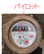
▲水道メーター
