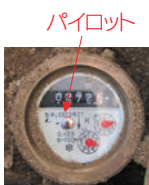
▲水道メーター
