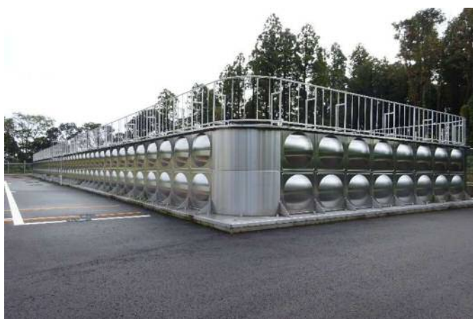
横山配水池 (平成 29 年3月完成)
