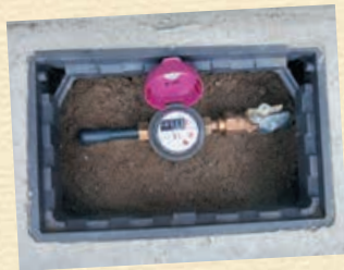
▲水道メーター
