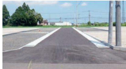
▲協議により、雨水を一時貯蓄するための大型側溝を設置した事例
