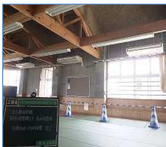
上小原中空調設備
