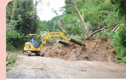
7月 大雨により市内各地で被害が発生 6月から降り続いた大雨で、土砂崩れによる農地や牛舎等の被害のほか、家屋の浸水や停電、断水などの被害が発生しました。
