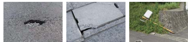
▲道路の異常箇所の例（穴ぼこ、蓋板割れ、ロードミラー倒れ）
