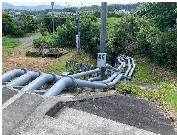
【川上樋管排水ポンプ】
