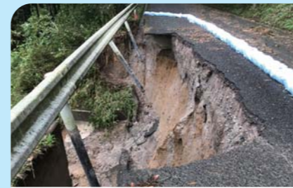
7月 令和2年7月豪雨による災害 7月上旬に降り続いた大雨により、道路の冠水や崩落、家屋への浸水や土砂流入など、市内各地に大きな被害をもたらしました。
