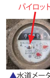
▲水道メーター
