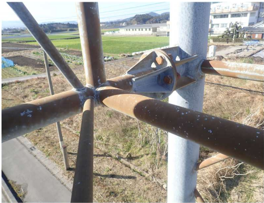
横梁トラス溶接部（健全性：Ⅱ）
