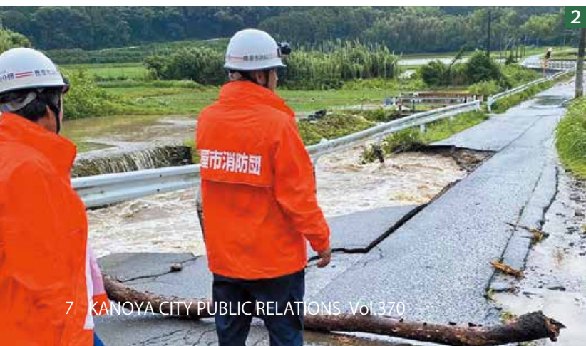
1 石垣の上まで水が浸かる状況の中、避難指示や状況確認作業を行った 2 大雨により道路が陥没。市内各地で計58箇所の路肩決壊があった
