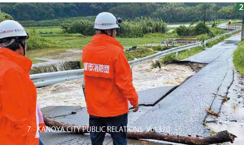
1 石垣の上まで水が浸かる状況の中、避難指示や状況確認作業を行った 2 大雨により道路が陥没。市内各地で計58箇所の路肩決壊があった
