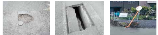
▲道路の異常箇所の例(穴ぼこ、蓋板割れ、ロードミラー倒れ)
