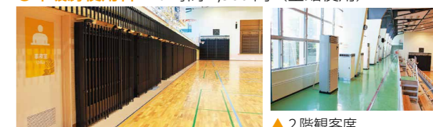
▲1階競技スペース「輻射式冷暖房機」 ▲2階観客席「対流式冷暖房機」
