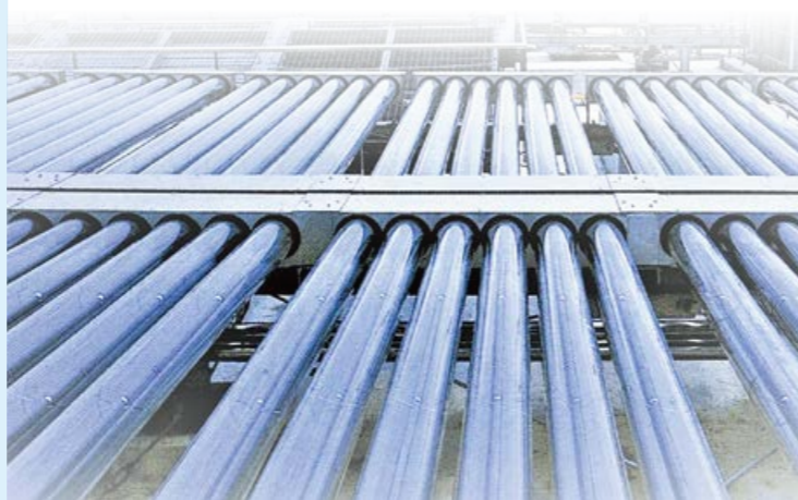
▼鹿児島県庁に設置された太陽熱温水設備
